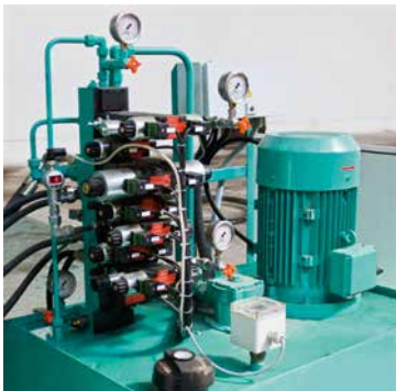
Hydraulikeinheit mit Hydraulikzylindern, Hydraulikventilen und Hydrauliksteuerung.
